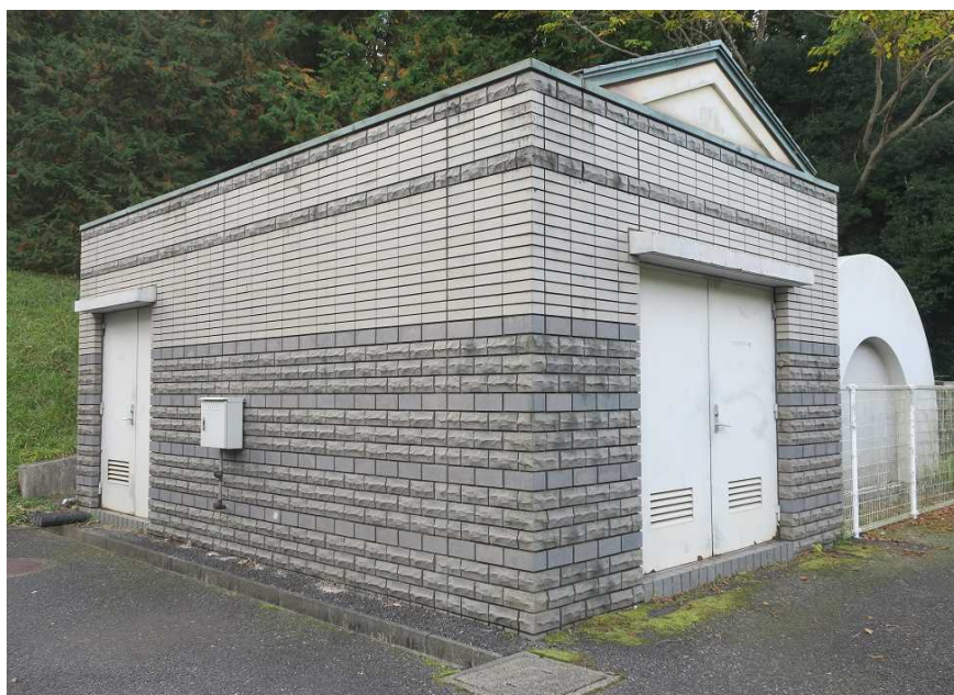
左：SD-3 ポンプ室
